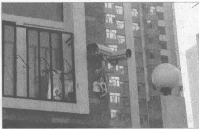
图1-14 住宅小区安装的摄像机
