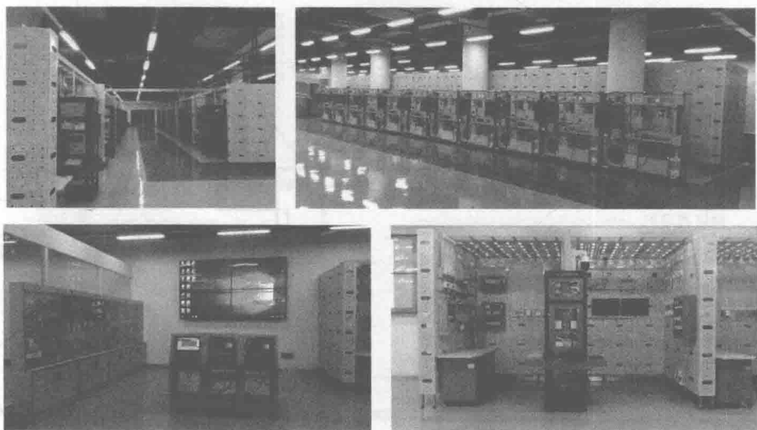
图7-7 中国公共实训中心（天津）智能楼宇工程实训中心设备照片
