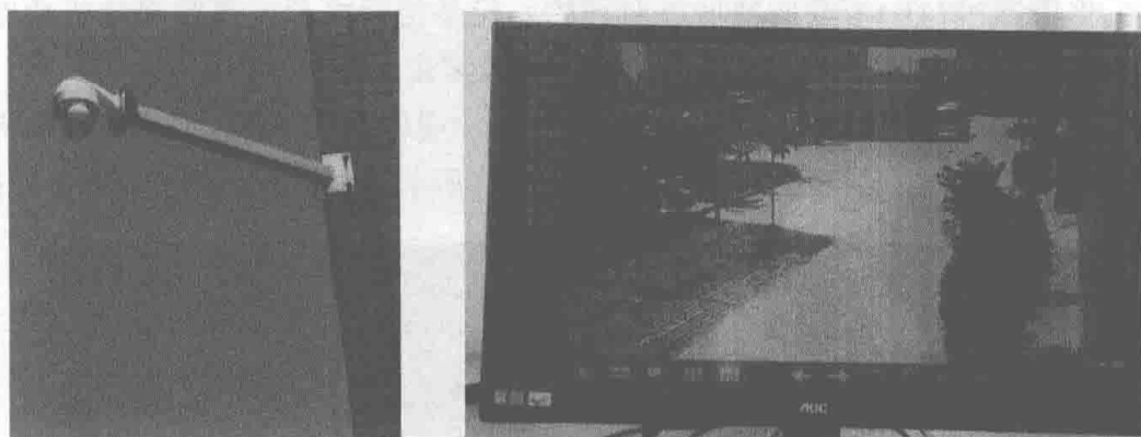
图5-44 室外墙角加长杆安装的全景摄像机和图像
