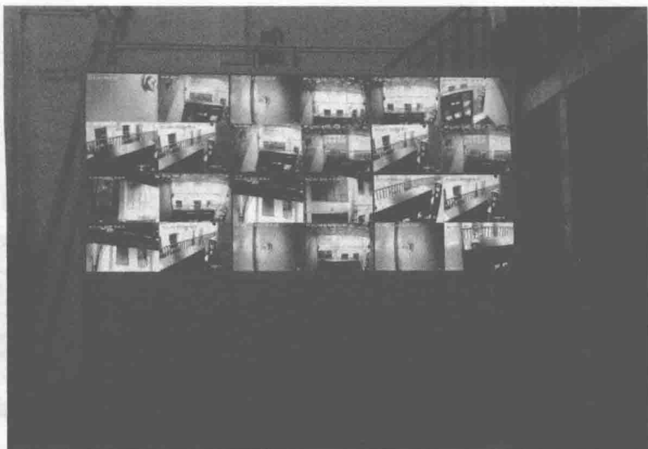
图5-65 电视墙竣工照片
