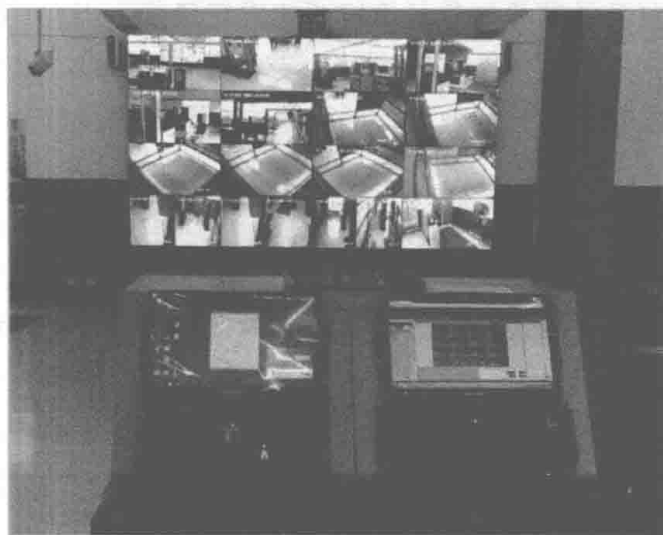
图2-63 监控电视墙和控制台
