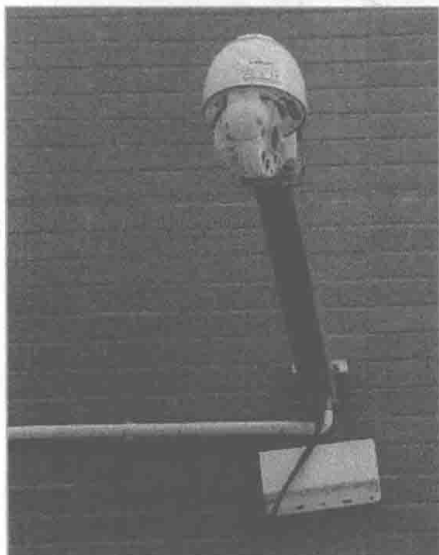
图1-16 墙面安装的全球摄像机和支架
