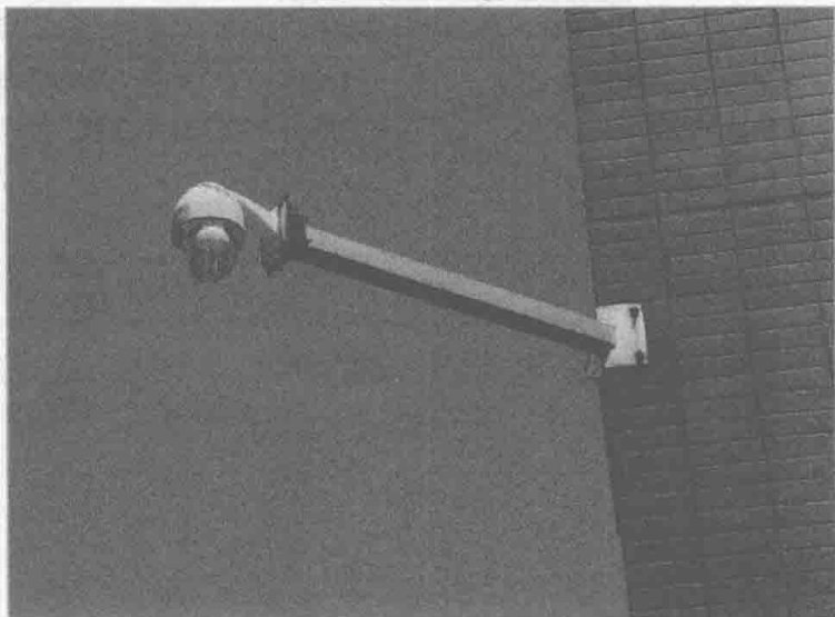
图1-17 墙角安装的全球摄像机和支架
